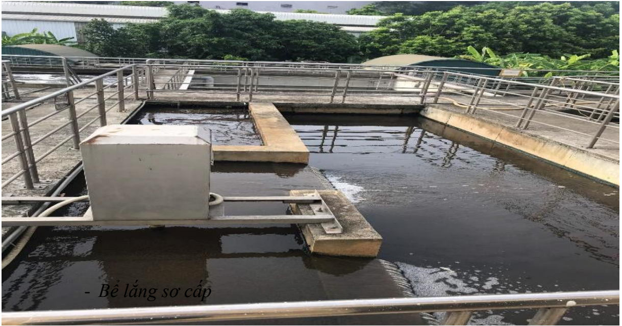
Hình 3.7 Bể phản ứng
