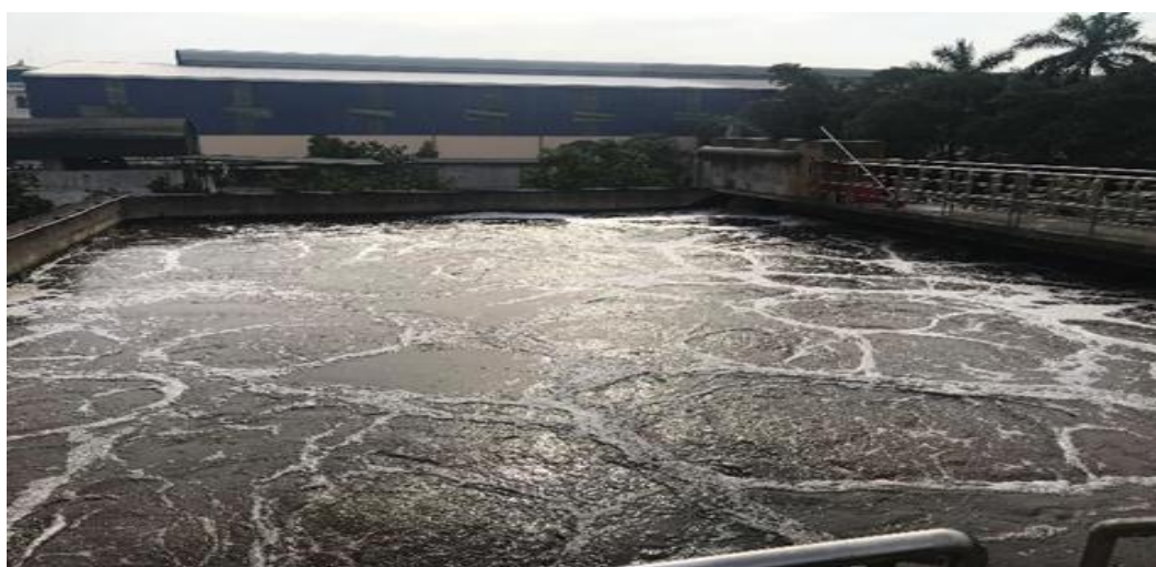
Hình 3.6 Bể điều hoà
